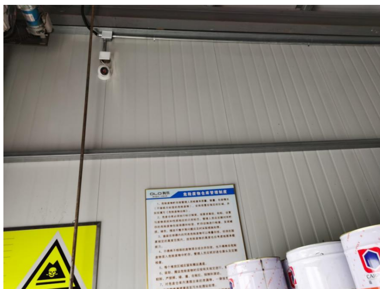
图 2-16 危废暂存库视频监控设施
