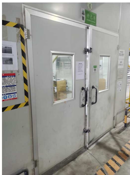
2. 喷漆房门未关闭严实
