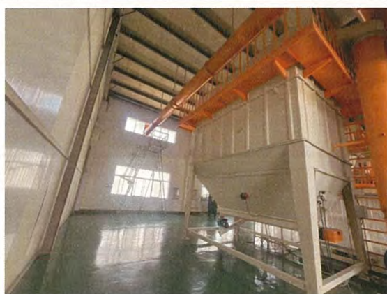
布袋除尘措施
