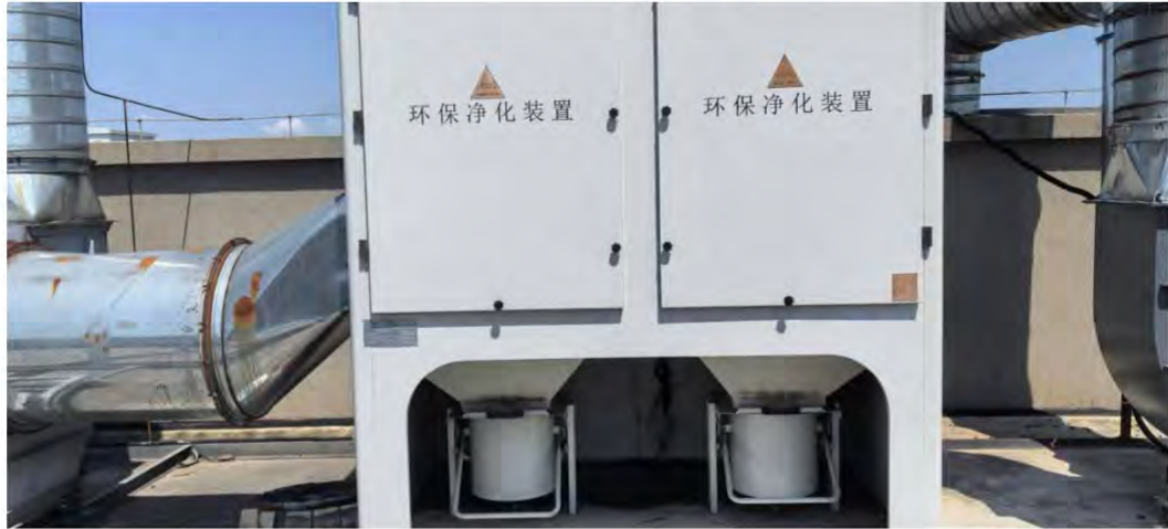
现有废气处理设施
