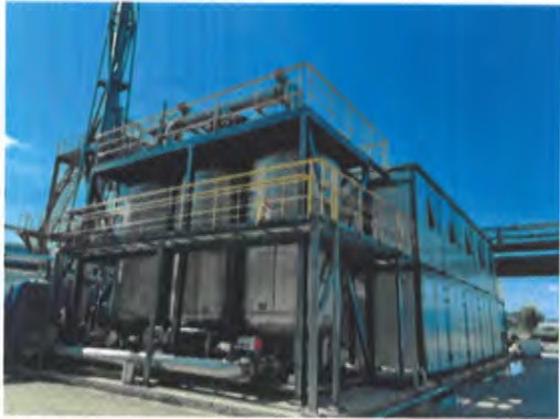
图 2-1 项目二氯甲烷气体回收装置样图
